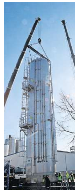
Der Säulentank ist rund 20 Meter hoch.
