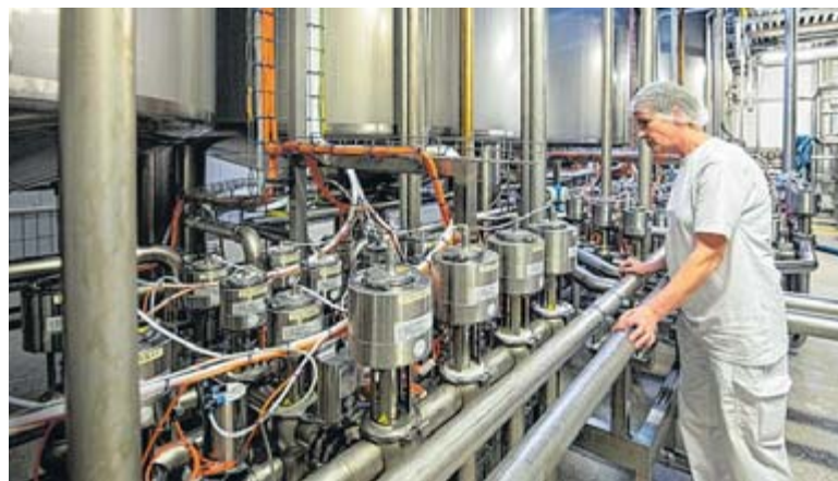
Mitarbeiterin Jana Eckhardt überprüft im Milchtanklager der Kohrener Landmolkerei die einzelnen Ventile. Von dort aus wird die Milch aus den Tanks in die verschiedenen Produktionsbereiche verteilt.
